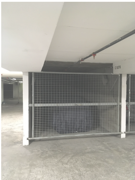
Protection sprinkler des boxes de garage
