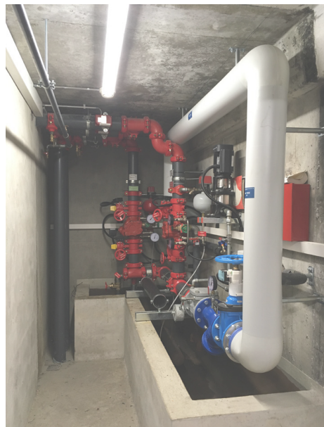
Centrale sprinkler du garage B
