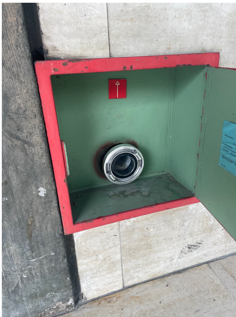
Nouvelle vanne d'entrée
